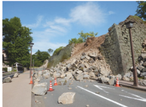
図-4 J1（百間石垣）崩壊の様子
