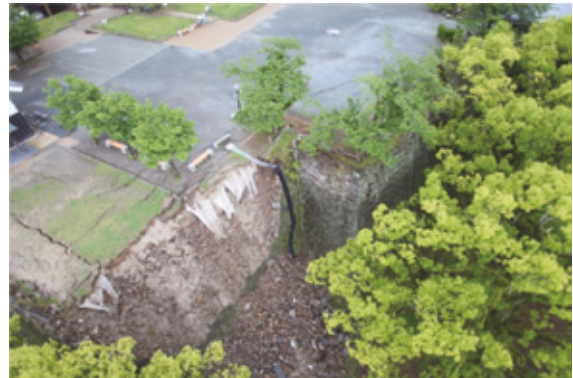
図-3 A2（長局櫓北側石垣）崩壊の様子
